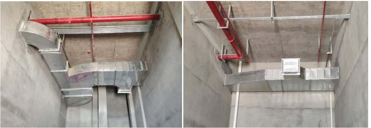
商铺预留油烟废气排放管道
