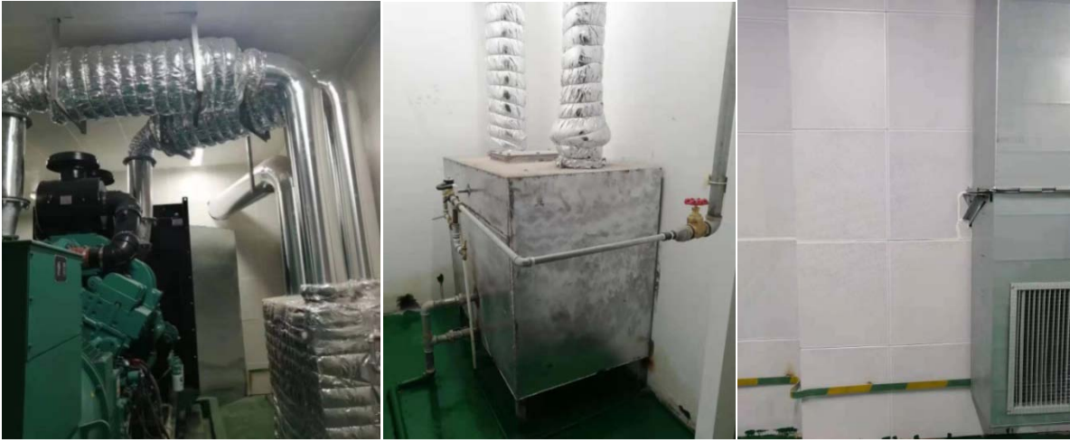
备用发电机废气水喷淋设施及发电机房吸声板设置
