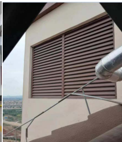
酒店厨房油烟废气排放口
